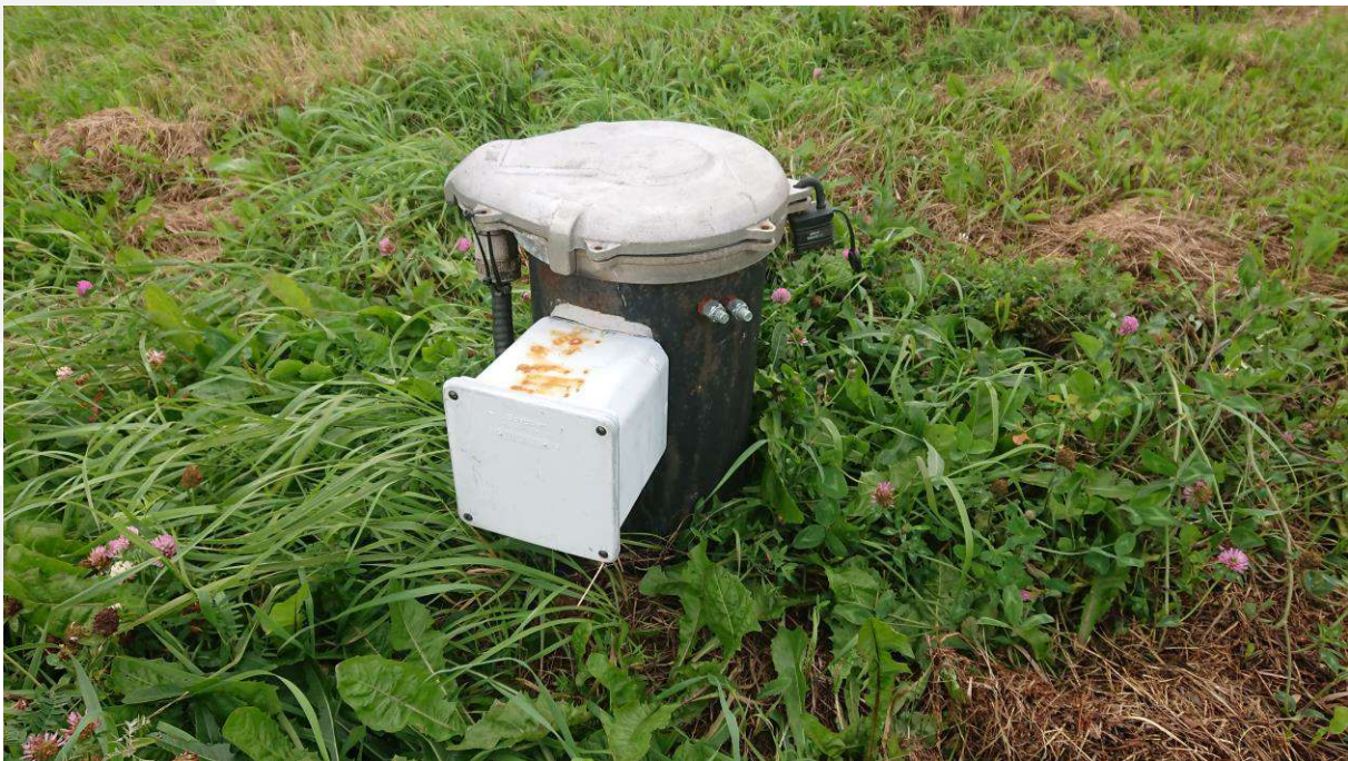
Figure 2 : Vues de l'installation de prélèvement X0010580-2
